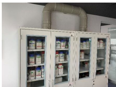
排风管（试剂柜）
