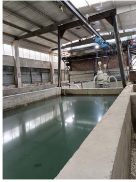
2#厂房三级沉淀池
