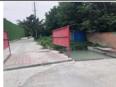
2#厂区出口隔油沉淀池
