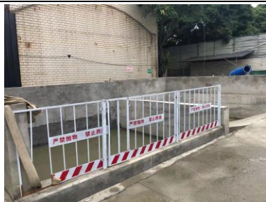
1#厂区出口隔油沉淀池
