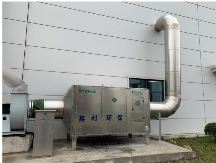
图 3-1 项目废气处理设施及排气筒
