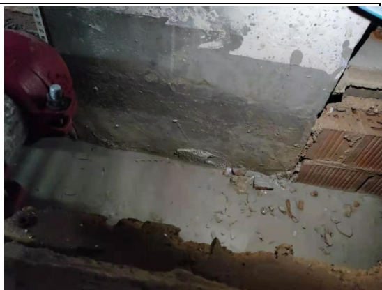
垃圾房防渗措施
