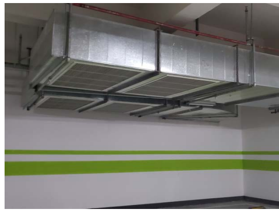
地下车库抽排风系统
