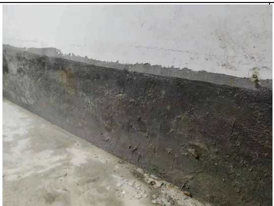
垃圾房防渗措施
