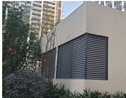
汽车尾气地面绿地排风口
