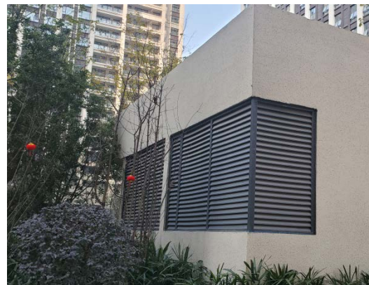
汽车尾气地面绿地排风口
