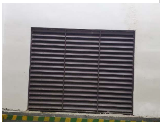
柴油机房机械排风
