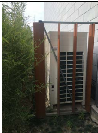
空调外机周边进行了绿化隔音
